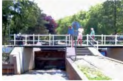
Afb. 6 De gerestaureerde Dubbel Verlaat. Links de Sluipwijkse Wetering met de weer operationeel gemaakte sluisdeur. Aan de andere zijde van de kade de Reeuwijkse Wetering. Op de sluis uiterst rechts Han Breedveld. Foto: Carin Gaemers.
